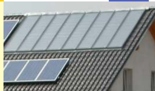
Solarthermiekollektoren oben rechts Foto: Karayel
